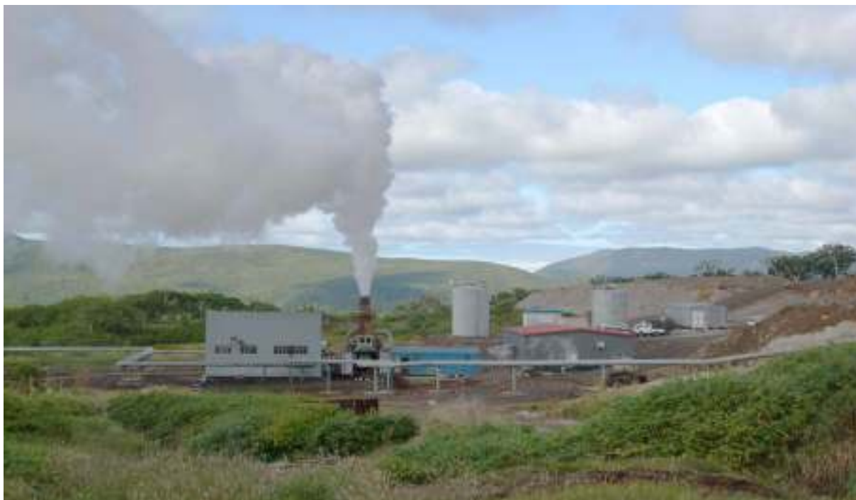
Рис. 358. Геотермальная электростанция на Океанском месторождении парогидротерм (влк. Баранского, о.Итуруп). Фото Т.И. Ньюшко, 2008 год.
